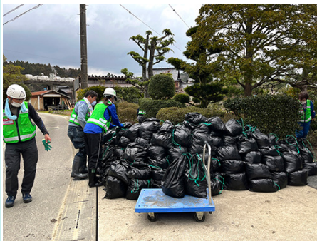
津波被害を受けた住宅で庭や畑の泥だしをしました
